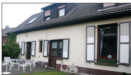
Vorher: In Bodennähe gab es viele feuchte Stellen
