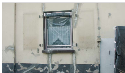
Zustand mit Rissen und Abplatzungen
