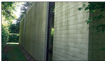
Vorher: Algen- und Moosbefall
